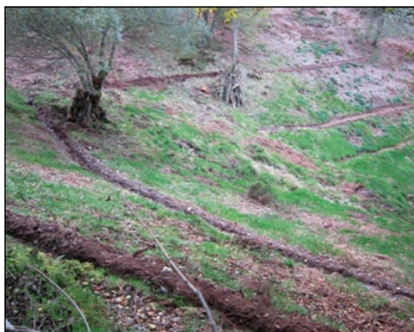
Desbroce y recuperación del sistema del riego de la Regueira Fundada. Foto: Quei Vitorino.
