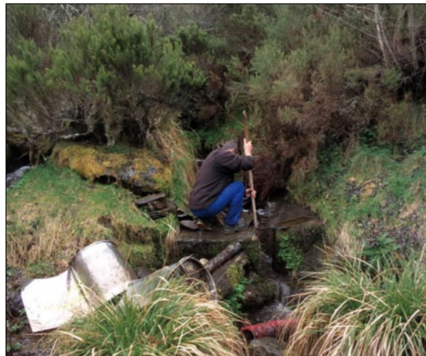
Limpiando la toma de aguas, los arrastres atoran la captación.
