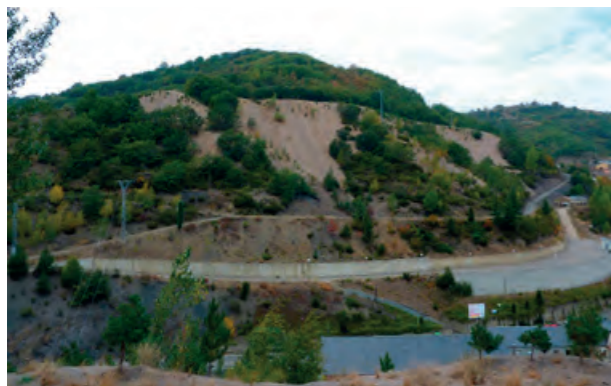
Figura 3. Escombrera recién restaurada en Tremor de Arriba. El color pardo se debe a la malla de coco que cubre la zona restaurada.
