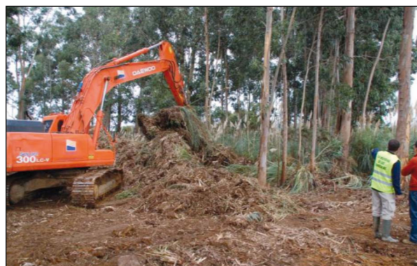
A lo largo del proyecto ha sido necesario el uso de maquinaria pesada para la eliminación de flora exótica y la excavación de las lagunas
