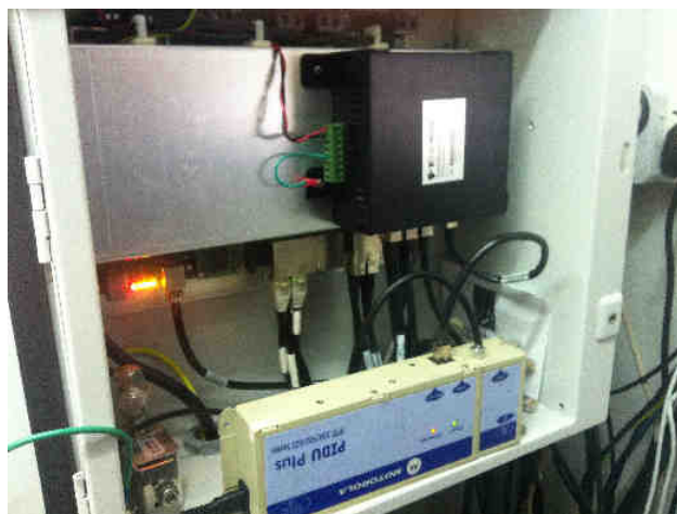
Ubicación de componentes en la caseta de comunicaciones del Monte Pajariel ( CMM4 1090CK )
