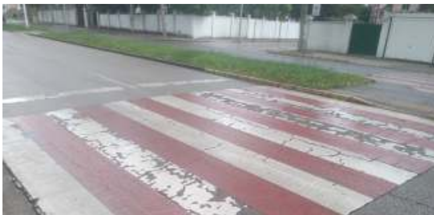
Avenida del Castillo. Paso peatonal con exceso de pintura y adherencia reducida en humedad.
