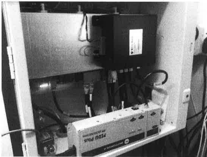
Ubicación de componentes en la caseta de comunicaciones del Monte Pajariel (CMM4 1090CK)
